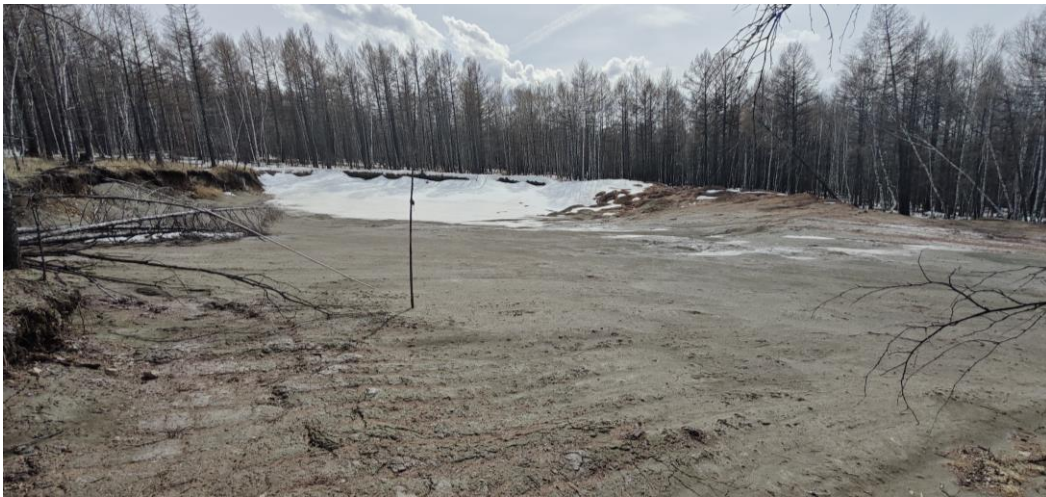
照片 4-2 塌陷区回填前
