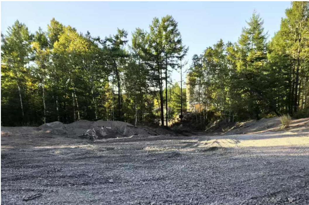
照片 4-3 塌陷区回填后
